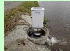
【自動給水栓設置状況】
