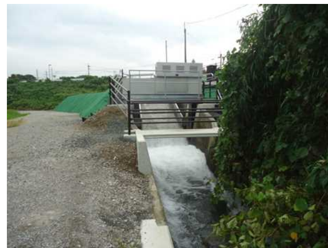
姉川エコ発電所1号機(米原市)
