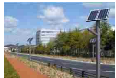
ソーラーLED照明
