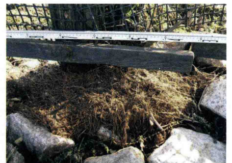
写真2 ヤナギ根の伸張状況
