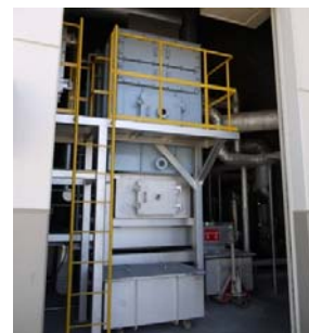
チップボイラー
