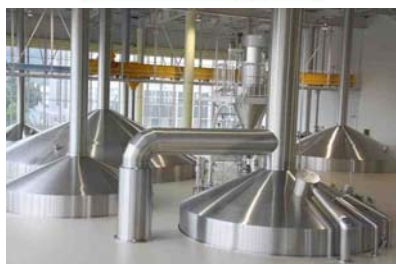
新醸造棟仕込釜
