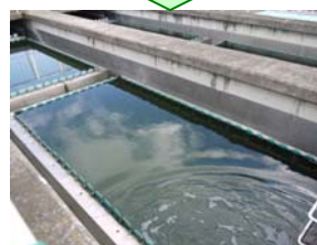
④最終沈殿池
