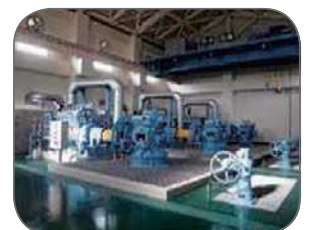
ハード対策の例 高効率電動機への更新による高効率化（東近江市）
