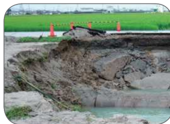
管水路の破損
