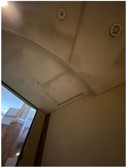
陶芸館地下天井(雨漏り)
