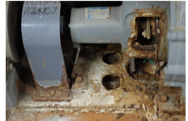
ボイラー室冷温水ポンプ
