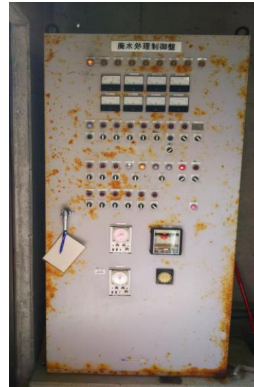
糞薬処理制御盤 (外観)
