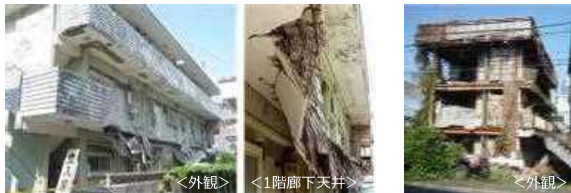
2階の廊下部分が崩落した事例
