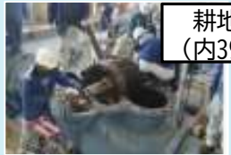
揚水機の診断
