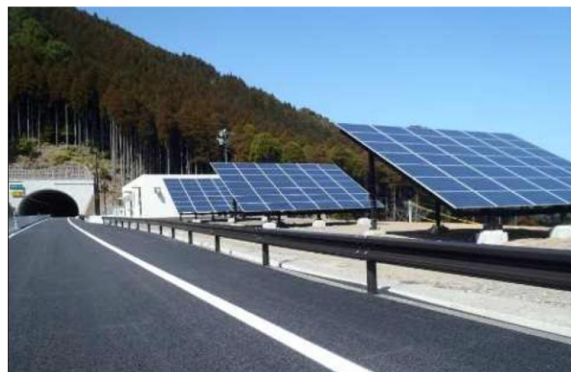
道路における太陽光発電施設活用(国土交通省)
