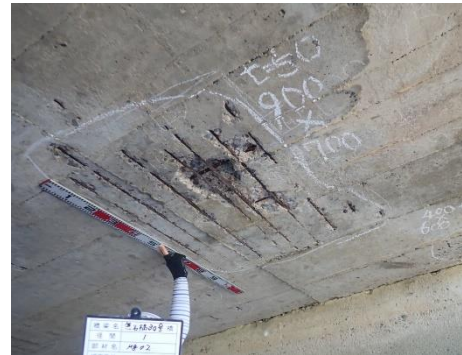
橋梁の老朽化による損傷事例
