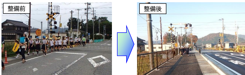
通学路の安全確保のため踏切前後の歩道を整備した事例
