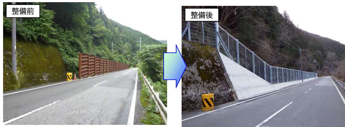
落石防護柵による落石防止対策 (国道306号)
