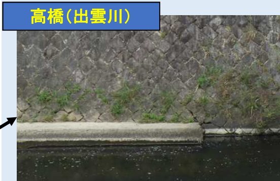
<量水標設置前>
