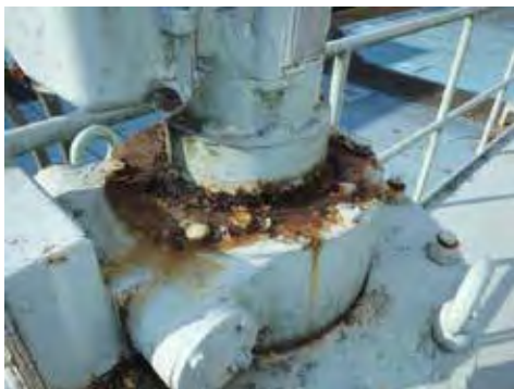
図 2. 湖南中部浄化センター No.1 汚泥掻寄機 (腐食)
