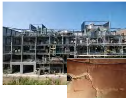
図 3. 東北部浄化センター 焼却炉 (耐火煉瓦クラック)
