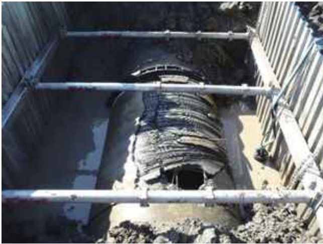
管水路の破損
