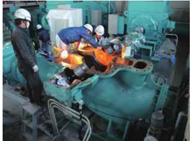
ポンプの点検
