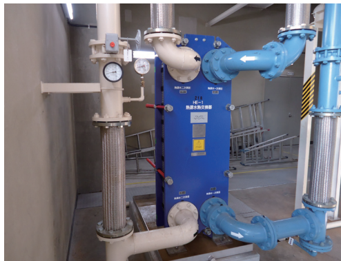
処理水の熱を熱源水に移動させる熱交換器
