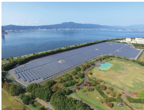
矢橋帰帆島メガソーラー発電施設
