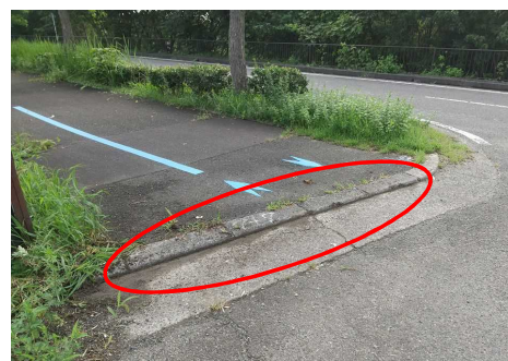
巻込み部の段差
