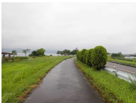
植栽帯による視距不良
