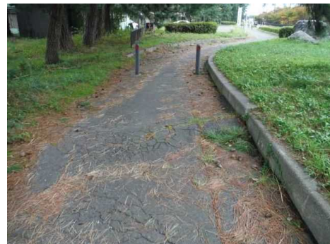
樹木の根による舗装の隆起
