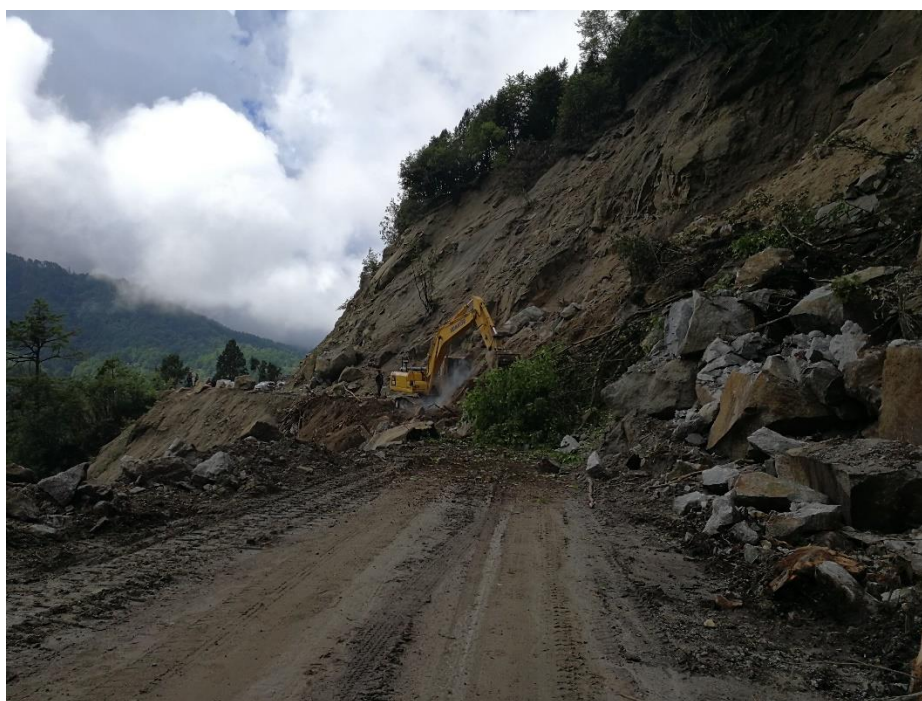
崖崩れによる通行止め
