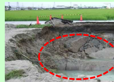
埋設管の損傷による道路の陥没
