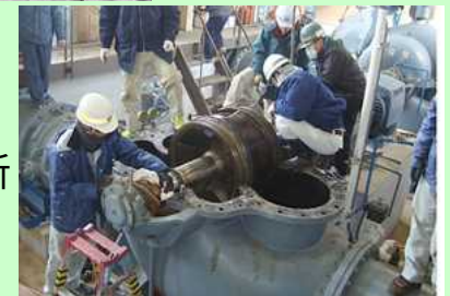
揚水機の診断
