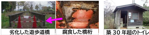
劣化した遊歩道橋
