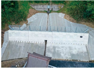
▲治山施設（落石防護工）
