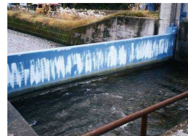
余呉川導水路洪水調節ゲート
