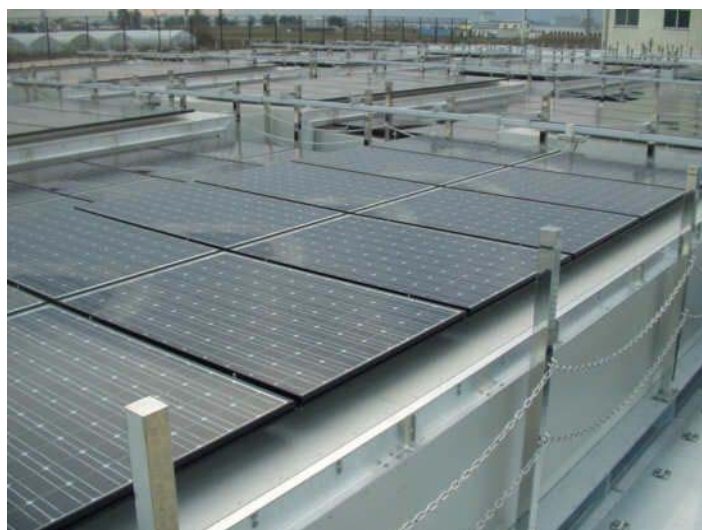
太陽光発電設備（吉川浄水場）
