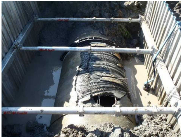
管水路の破損
