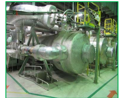
【補機冷却水熱交換器】
