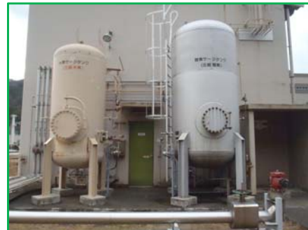
【水素・酸素サージタンク】
