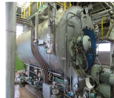
補助ボイラー
