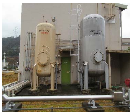
ガスを貯蔵するタンク
