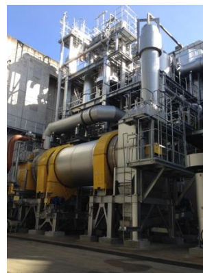
湖西浄化センター 汚泥燃料化施設
