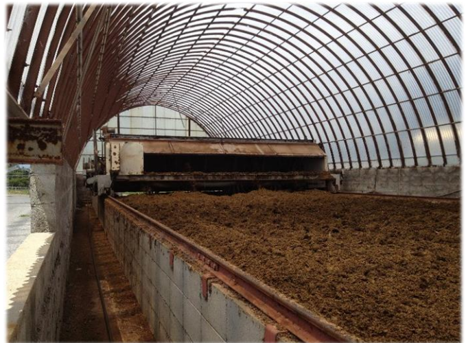
発酵堆肥化施設
