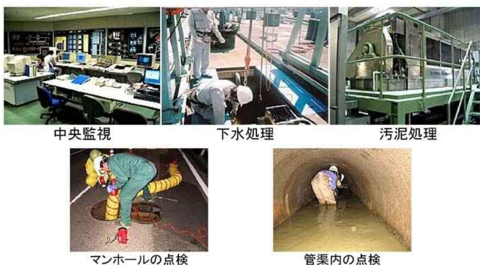
図 3-2-44. 下水道施設の管理状況
