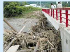
流木が詰まった橋梁
