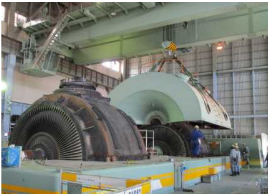
【蒸気タービン】
