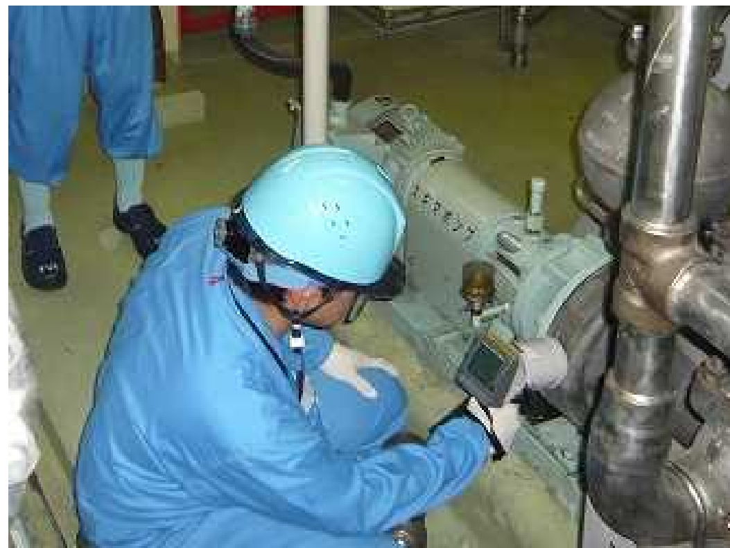
測定器を用いて機器表面の放射線線量率を測定
