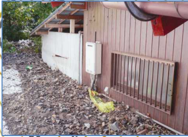
土砂が1.8mぐらい堆積し、 埋もれた家。
