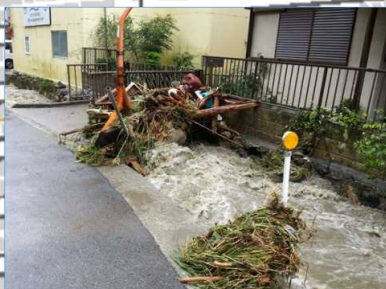
流木等が詰まった橋
