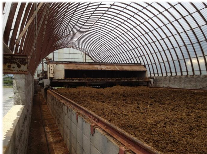
発酵堆肥化施設
