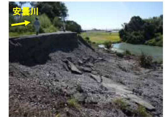
堤防崩落状況 （高島市安曇川町川島地先）
