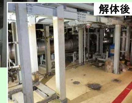
隔離冷却熱交換器
