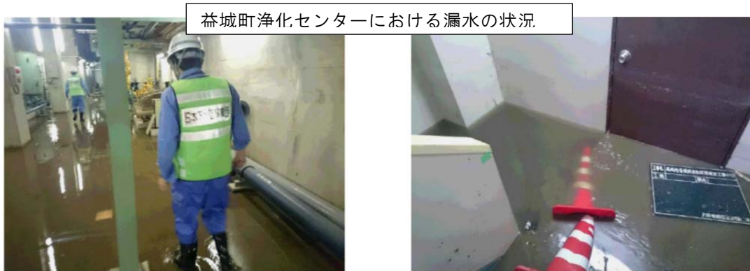
図 3-2-28. 熊本地震における下水道施設の被害の状況
