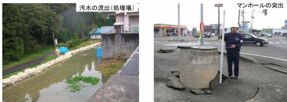
図 3-2-26. 新潟県中越地震における下水道施設の被害の状況
