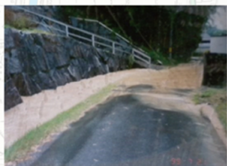
水路の氾濫写真 (Nさん提供)
