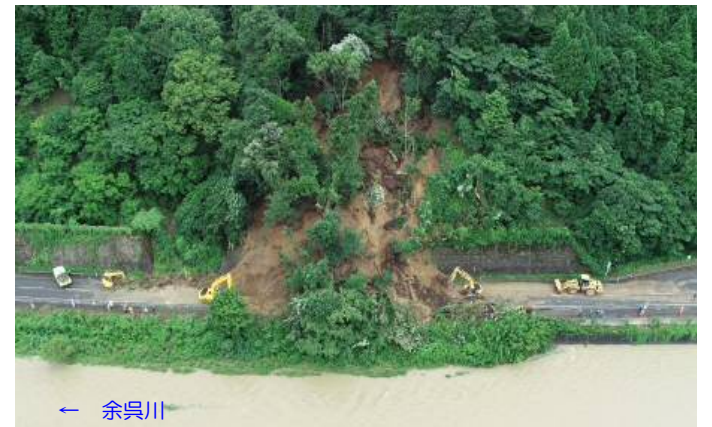
国道365号（黒田）での斜面崩壊
