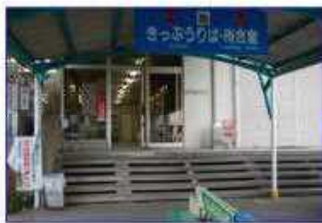
ターミナル入口にスロープ・手摺等が無く、円滑な移動に支障がある状態
