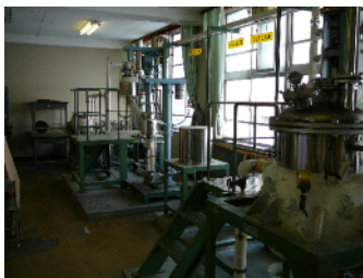
( 写真 : 長期間使用のないプラント装置 )
