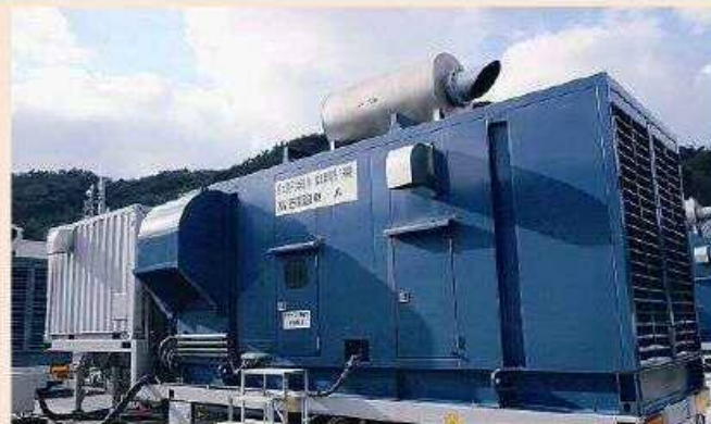
空冷式非常用発電機
