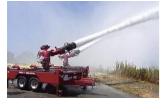
【屋外放水設備】
