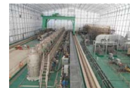
(高性能多核種除去設備の設置状況)
