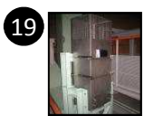
19 静的触媒式水素再結合装置【5台/ユニット】
