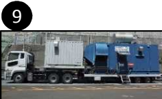
空冷式非常用発電装置 【4台/2ユニット】
