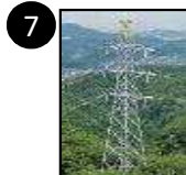
外部電源(既設)
