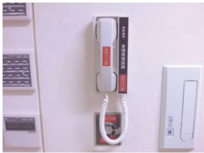
非常通報ボタン
