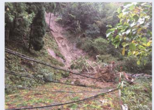
平成29年10月台風21号による国道367号(保坂地先)の被災状況
