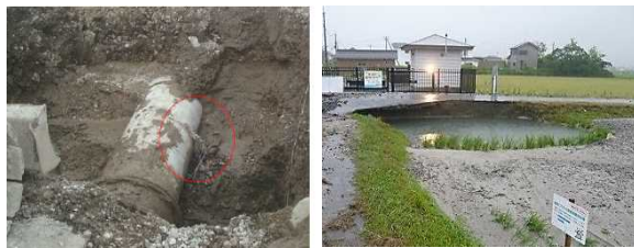
【農業水利施設の老朽化による突発事故の発生】
