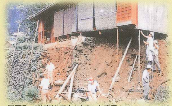
写真2 がけ崩れで土台を失った家屋(S57 多賀町入谷)
