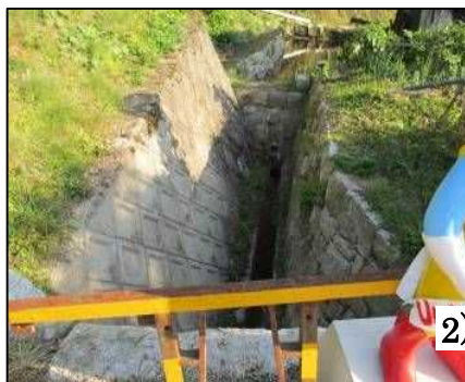
▶ 写真 2) 左写真 1) で水位が 2/3 になると小水路は溢れる
