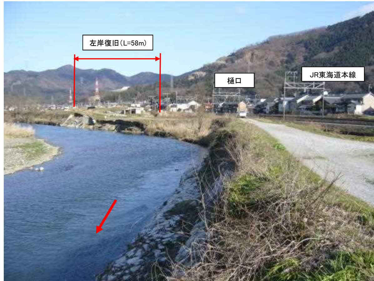
米原市樋口地先 左岸L=58m H=5.2m (9月19日の豪雨により被災)
